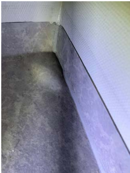
Luftlomme, under vinylbelegg, oppbrett har glipper bak og er skåret i ved tidligere anledning.
