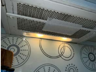
Kontroll av ventilator.
