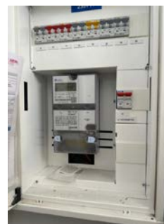
Sikringsskap med automatsikringer.
