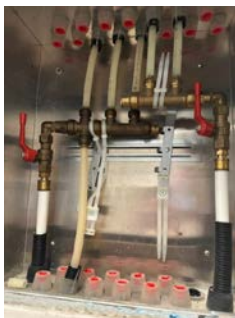
Samleskap med rørkurser og stoppekraner
