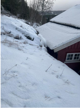
Terrenget faller inn mot bygningen
