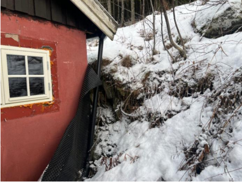
Terrenget faller inn mot bygningen
