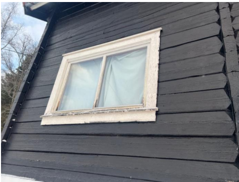
Vinduer er malingslitt utvendig
