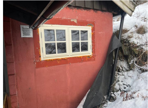
Vinduer på bad og soverom er ikke listet utvendig
