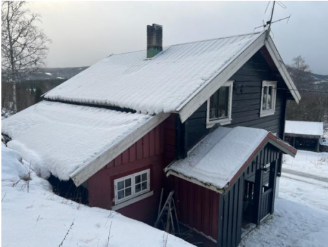
Pipe over tak uten topphelle
