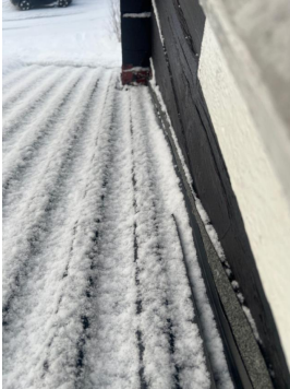
Ikke montert beslag ved overgang tak/yttervegg
