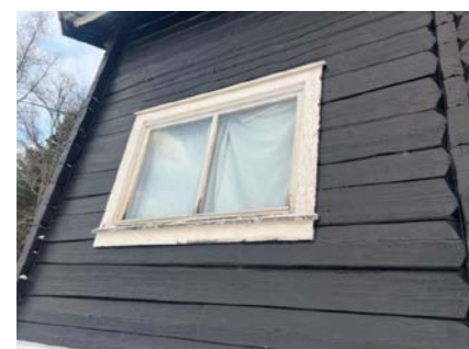
Vinduer er malingslitt utvendig
