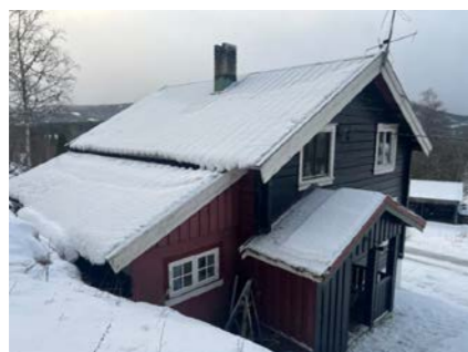
Pipe over tak uten topphelle
