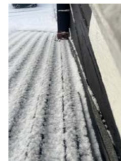
Ikke montert beslag ved overgang tak/yttervegg
