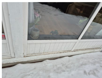
Værslitt treverk i bunn av vinduer.
