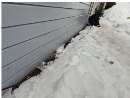
Kledningsbord helt ned til terreng.
