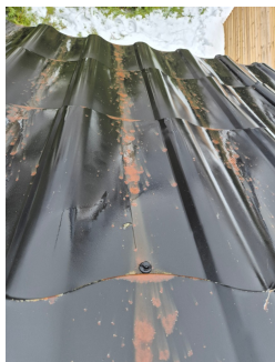
Overflatekorrosjon på stålplater.
