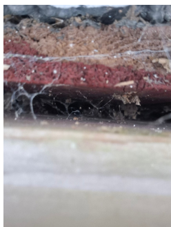
Ingen musesperre i nedre del av kledning.
