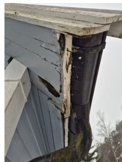
Råteskader i gesimser og forkantbord.
