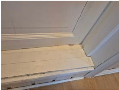
Baderomsdør i hybel går i terskel.
