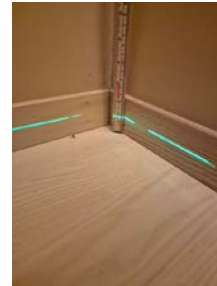
Målt skjevheter på 30 mm over hele soverom.
