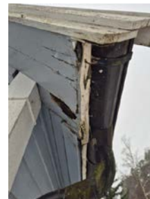
Råteskader i gesimser og forkantbord.
