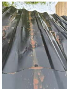
Overflatekorrosjon på stålplater.
