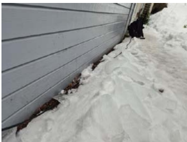
Kledningsbord helt ned til terreng.
