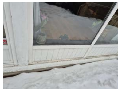
Værslitt treverk i bunn av vinduer.
