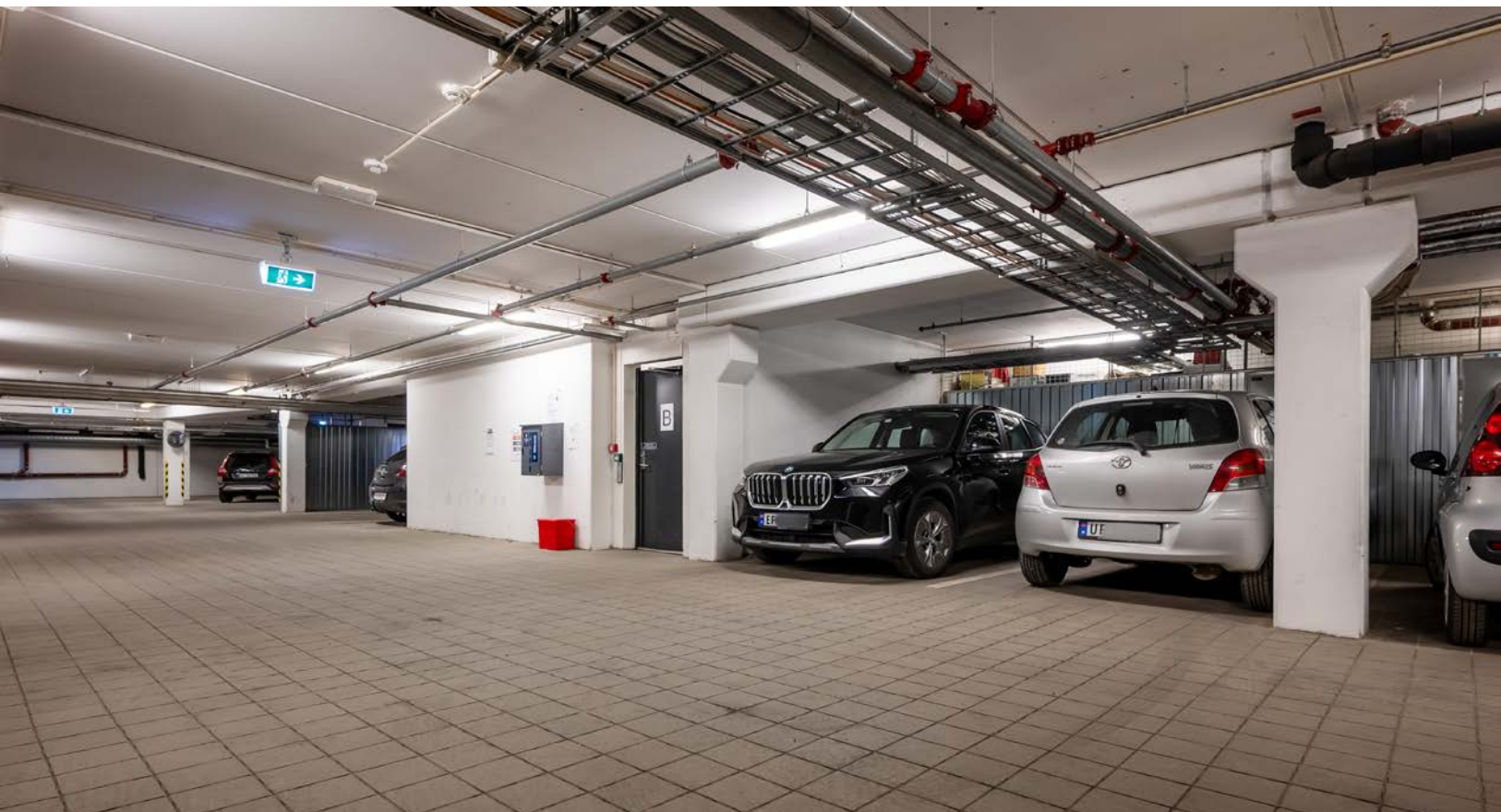
Garasje plass med elbil-lader.
