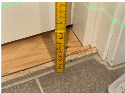
Fallforhold ca. 95 mm overkant gulv ved terskel
