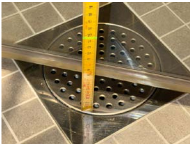
Fallforhold ca. 145 mm topp slukrist i dusjsone
