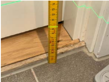
Fallforhold ca. 95 mm overkant gulv ved terskel
