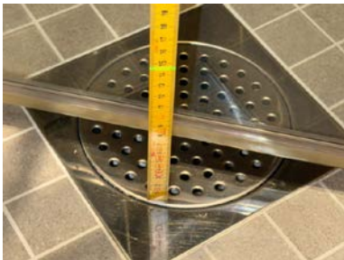
Fallforhold ca. 145 mm topp slukrist i dusjsone
