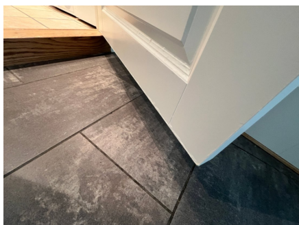
Fuktsvelling på dørblad.
