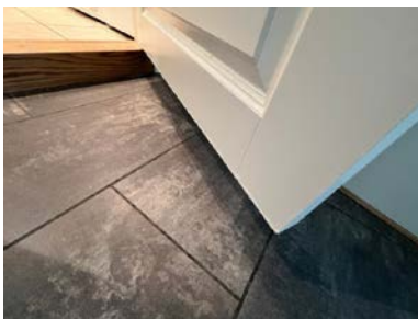
Fuktsvelling på dørblad.
