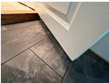
Fuktsvelling på dørblad.
