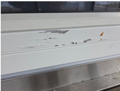
Avksalling på balkong-skyvedør
