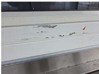
Avksalling på balkong-skyvedør
