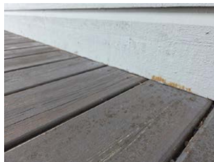
Tett mellom kledning og terrassebord.
