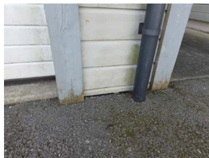
Tett mellom kledning og terreng/asfalt.
