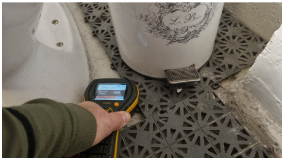
Plastfliser på gulvet gjør det vanskelig å komme til sluken.
