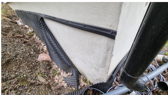
Grunnmursplast har løsnet fra klemlist
