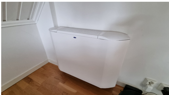
Konvektorovn i loftsetasjen.
