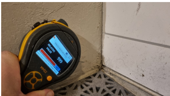
Fuktmåling i yttervegg, forhøyede fuktverdier ble registrert.
