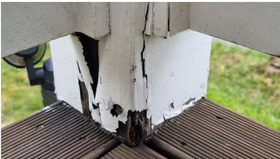
Begynnende svekkelser i rekkverk.
