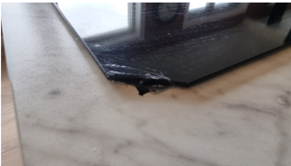
Sårskade i koketopp.
