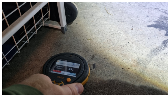
Fuktmåling i gulv i sokkeletasjen, forhøyede fuktverdier ble registrert
