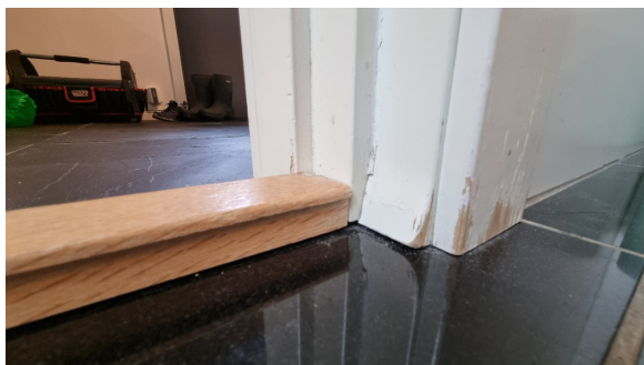
Fuktskader i utforing og lister ved dør.
