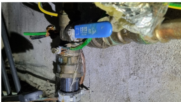
Kontroll av innvendig hovedstoppekran.
