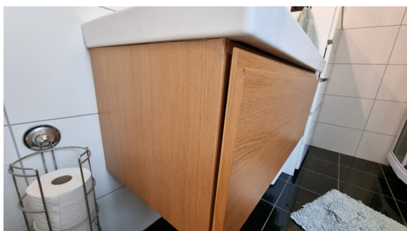
Skuff kommer i konflikt med røropplegg.
