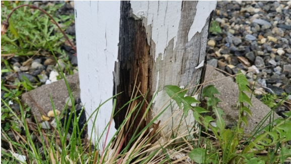
Råte i søyler.
