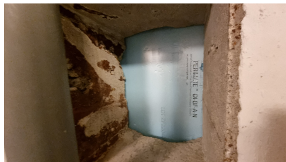
Ved et hull i yttervegg i sokkeletasjen ser man rett på styrofoamplate som er lagt på utsiden av grunnmuren.
