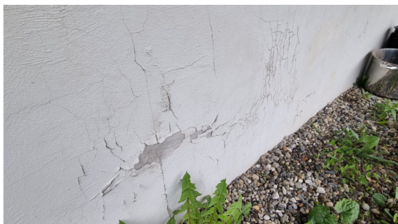
Stedvis noe avflassing i utvendige grunnmur.
