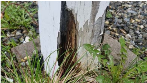
Råte i søyler.
