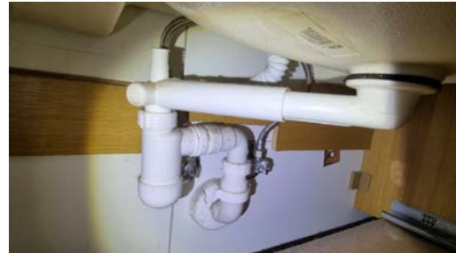
Kontroll av rørøpplagg under servanten.
