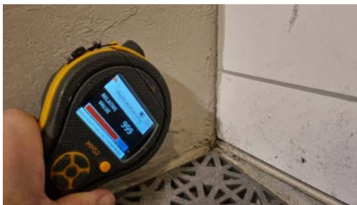
Fuktmåling i yttervegg, forhøyede fuktverdier ble registrert.
