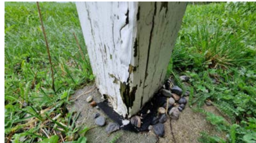
Måten søyle er fundamentert, gjør den veldig fuktutsatt
