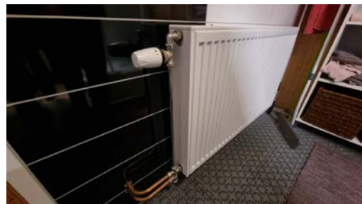
Radiator i sokkeletasjen.
