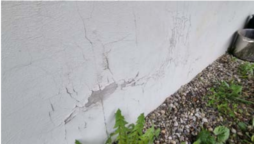
Stedvis noe avflassing i utvendige grunnmur.
