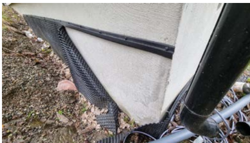
Grunnmursplast har løsnet fra klemlist
