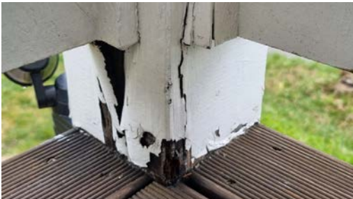
Begynnende svekkelser i rekkverk.
