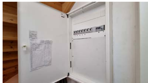
Kontroll av el-skapet øverst i trappeløpet mellom sokkeletasje og hovedetasje.
