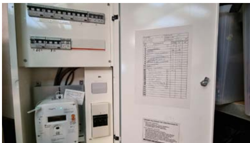
Kontroll av el-skapet i sokkeletasjen.
