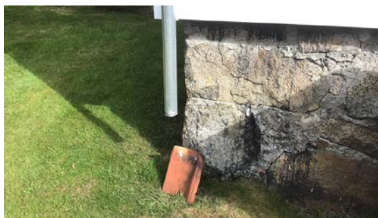
Mangelfull bortledning av takvann fra grunnmur
