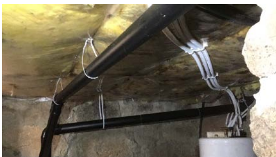
udekket isolasjon i tak
