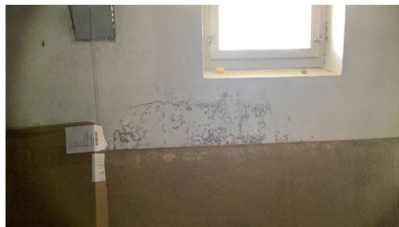
Eksempel på saltutslag og avskaling.
