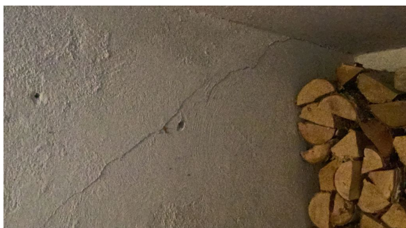
Eksempel på innvendig sprekk.
