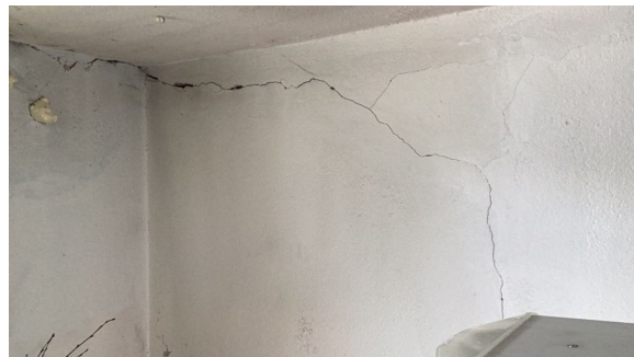
Eksempel på innvendig sprekk.
