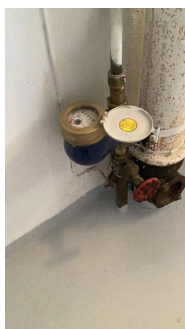
Vanninntak med vannmåler og stoppekran i vaskekjeller.
