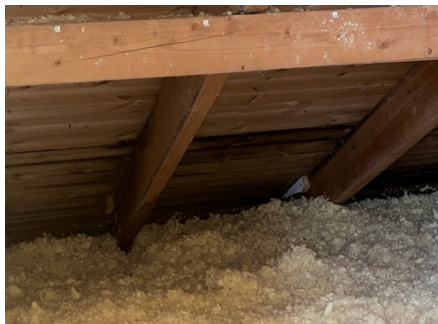
Eksempel på mørke områder på undersiden av taktro
