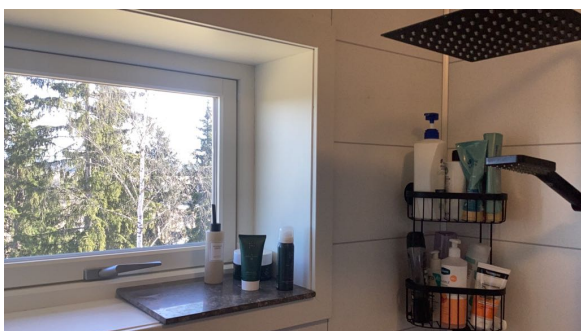
Det er vindu i våtsone i dusj.
