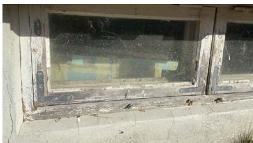
Eksempel på tilstand på kjellervindu.
