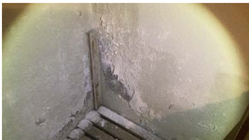
Eksempel på saltutslag og avskaling.
