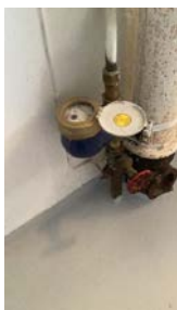
Vanninntak med vannmåler og stoppekran i vaskekjeller.
