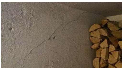
Eksempel på innvendig sprekk.
