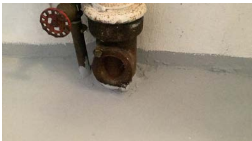
Stakepunkt i vaskekjeller.
