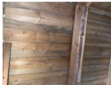
Eksempel på svertesopp på undersiden av taktro.
