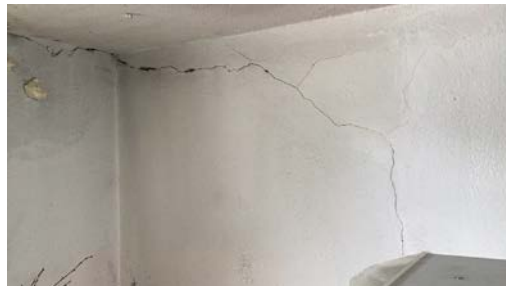
Eksempel på innvendig sprekk.
