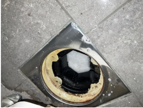
Sluk under dusjkabinett.
