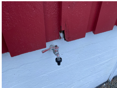
Kledning med råte.
