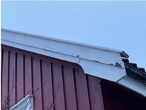
Råte på vindskie.
