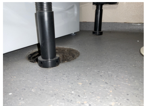
Plast sluk i gulv.
