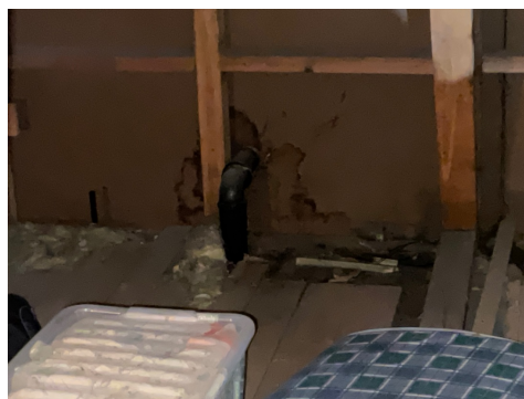
Fuktskjolder på vegg på loft.
