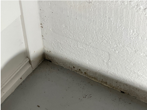
Fuktskjolder på vegg i kjeller.
