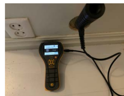
Fuktmåling i vegg
