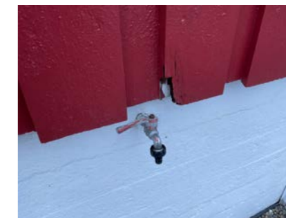
Kledning med råte.
