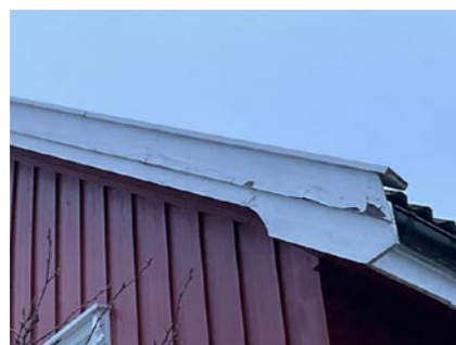
Råte på vindskie.
