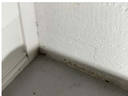
Fuktskjolder på vegg i kjeller.
