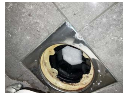
Sluk under dusjkabinett.
