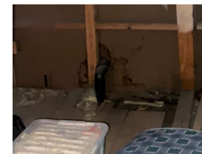
Fuktskjolder på vegg på loft.
