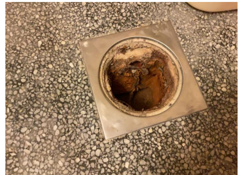
Sluk i gulv med rust.
