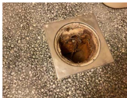
Sluk i gulv med rust.
