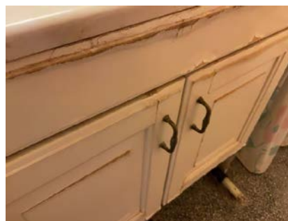
Fuktsvelling på baderomsinnredning.
