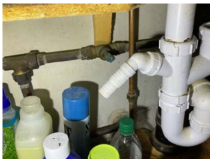
Defekt håndtak på stoppekran i benkeskap på kjøkken.
