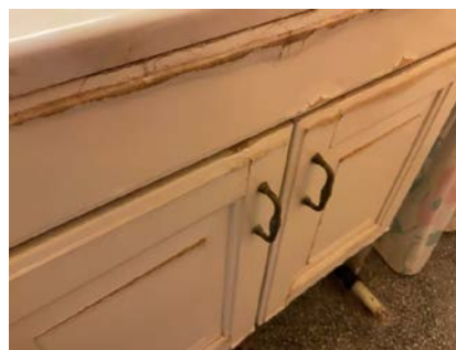
Fuktsvelling på baderomsinnredning.
