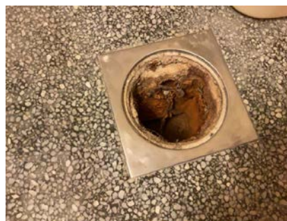
Sluk i gulv med rust.
