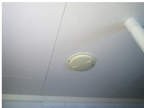
Avtreksventil fra bad.
