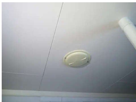
Skade rundt avtrekksventil i tak.
