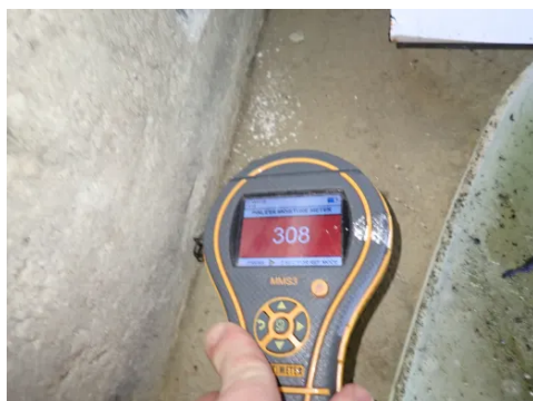
Viser fuktopptrekk ved måling i bodrom.
