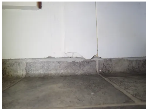
Skader i bunn av plater/fliser.
