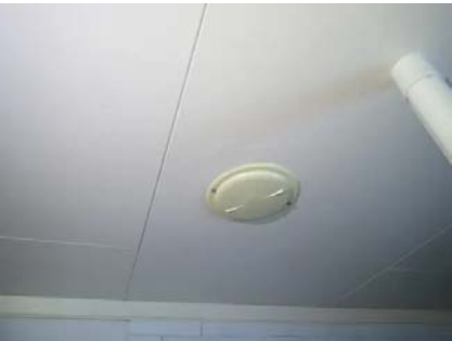
Skade rundt avtrekksventil i tak.
