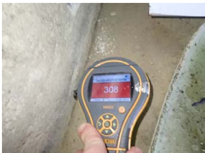
Viser fuktopptrekk ved måling i bodrom.
