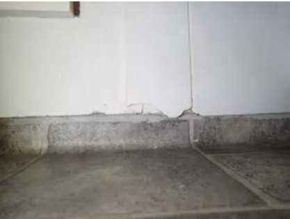
Skader i bunn av plater/fliser.
