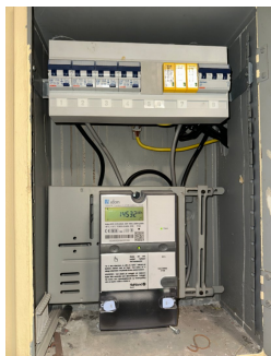
Sikringsskap med automatsikringer.
