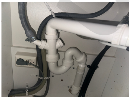
Rørøpplagg i kjøkkenbenk
