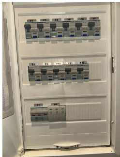
Sikringsskap med automatsikringer.
