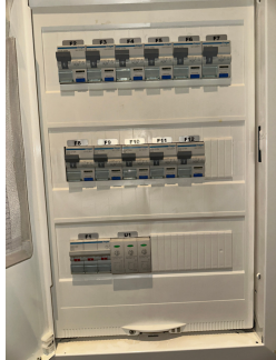
Sikringsskap med automatsikringer.
