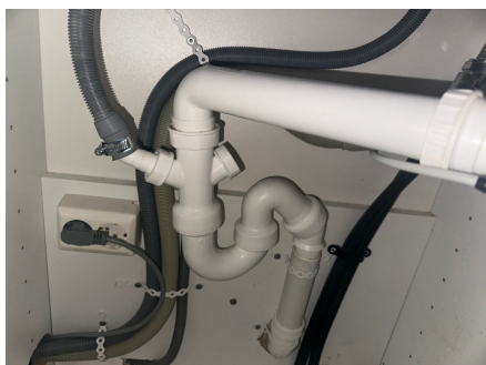
Rørøpplagg i kjøkkenbenk
