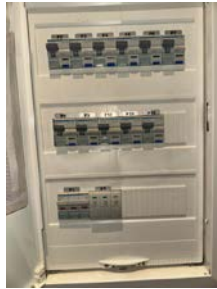
Sikringsskap med automatsikringer.
