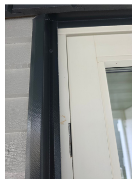
Balkongdør tar i karm. Trenger justering
