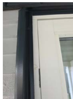
Balkongdør tar i karm. Trenger justering
