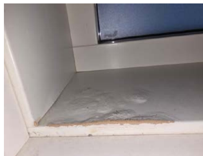
Fuktskadet utforing på bad
