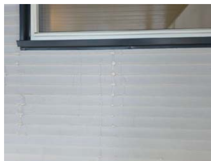
Isdannelse som kommer fra underkant av baderomsvind
