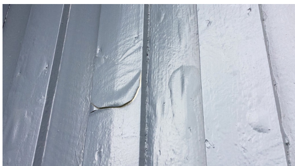
Eksempel på bobler i maling på fasade.
