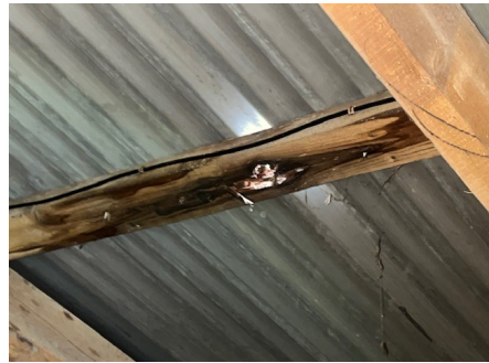
Mulig råte på spikerslag
