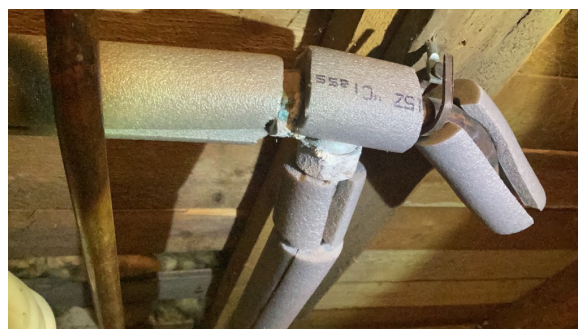
Stedvis korrosjon på skjøter.
