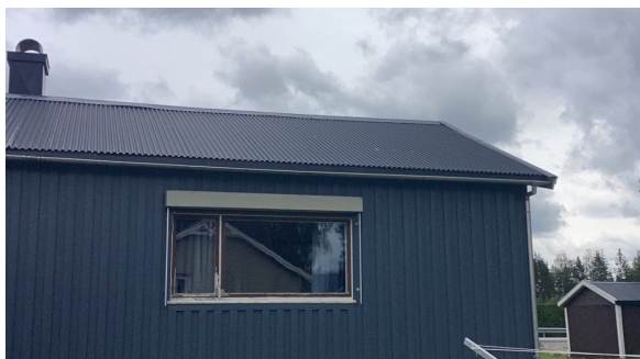
Nedsenk på takrenne på baksiden, usikkert med tanke på fallforhold.
