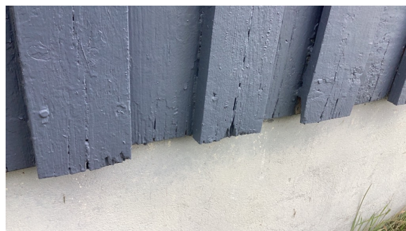
Eksempel på sprekker i kledningsbord mot sør.
