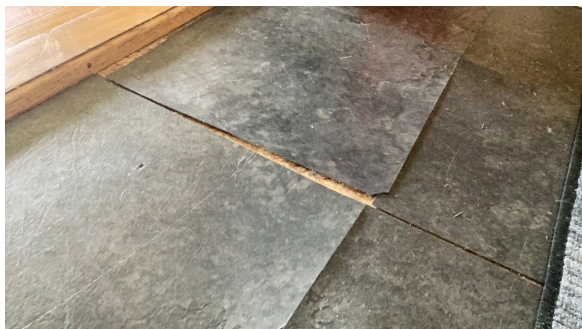
Vinylfliser i entre løsner.
