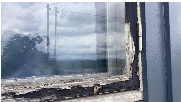
Eksempel på slitasje.
