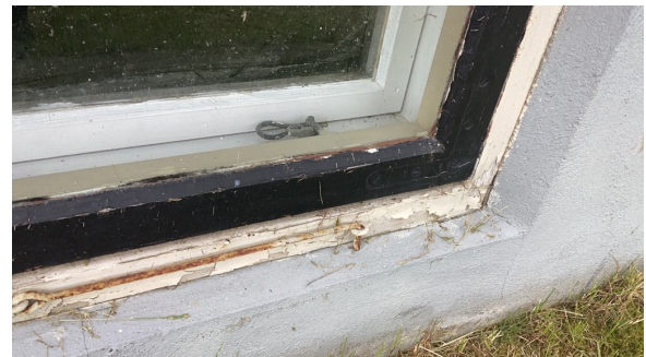
Eksempel på slitasje.
