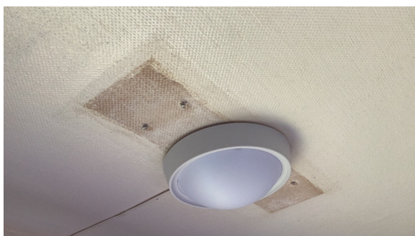
Misfarging i himling på kjøkken.
