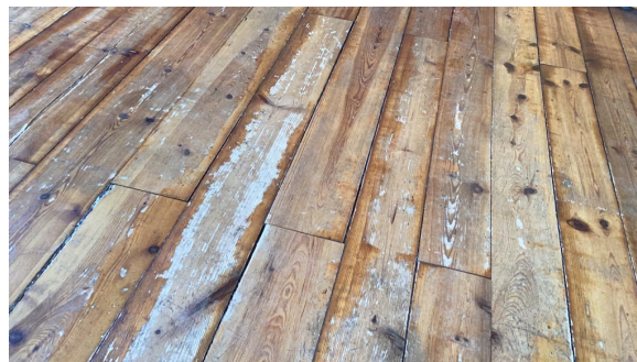
Slitasje på tregulv.
