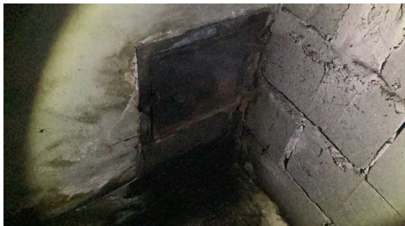
Sotluke i kjeller.
