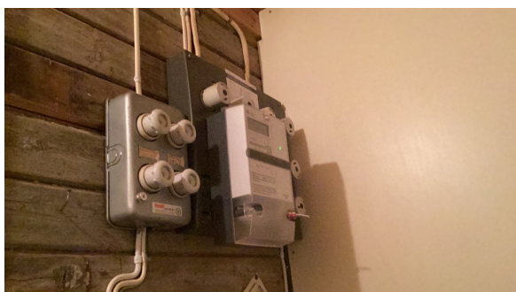
Åpne sikringer på vegg.
