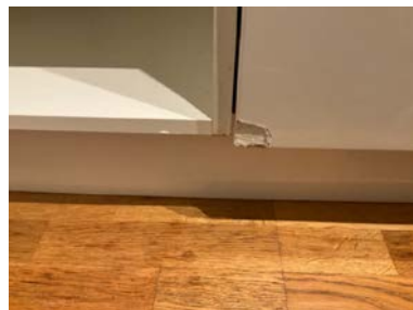
Liten skade på innredningen.
