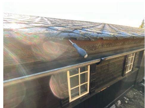
Råteskade flere steder i nederste bord i undertaket på nord-side.
