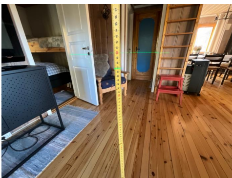
Måling av planavvik. Laserstrek viser 868mm.
