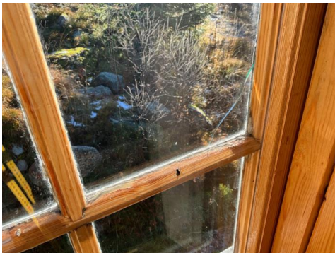
Sprekk i glass på vindu mot øst i spisestue.
