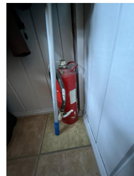
Pulverapparat, sist kontrollert 1997.
