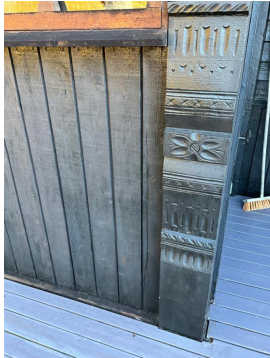
Sprekt kledningsbord på vindfang, fasade mot vest.
