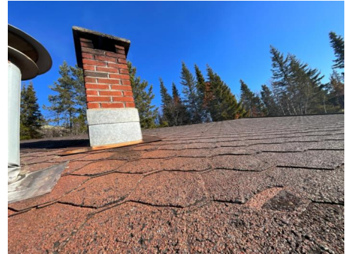
Mangler stigetrinn for feier.
