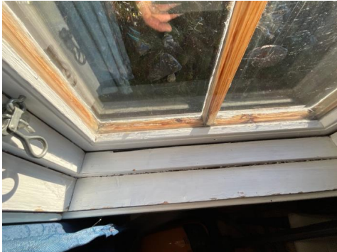
Tegn til innvendig kondensering på glass.
