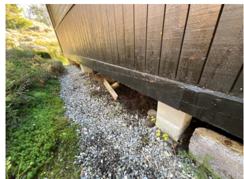
Stor sprekk i svillebord på nord-side.
