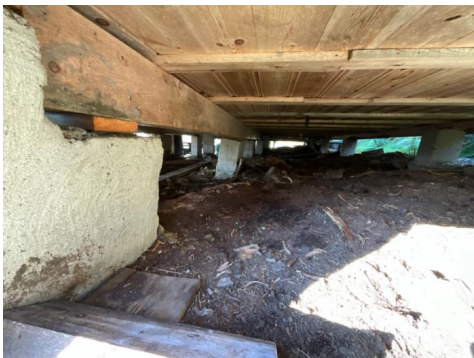
Bilde tatt under bygget viser skjeve fundamenter, bilde tatt på øst-side av bygget.
