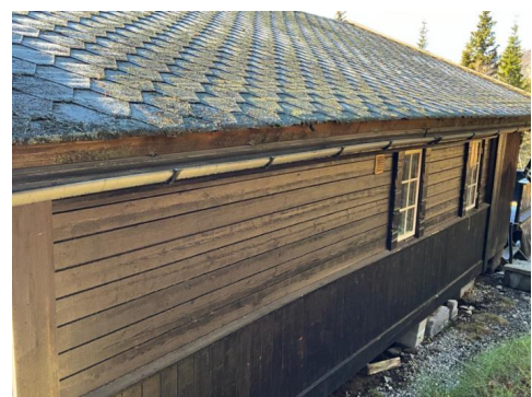
Taktekking preget av slitasje og elde.
