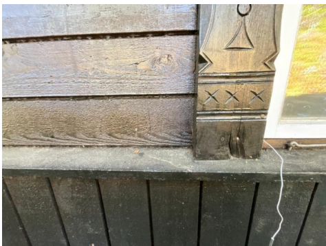
Skade på utvendig belistning, på nord-side
