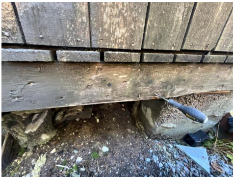
Råteskade i bunnstokk på nord-side, ved vindfang.
