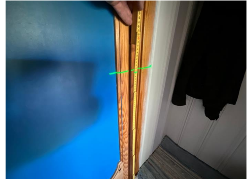
Måling av planavvik. Laserstrek viser 896mm.
