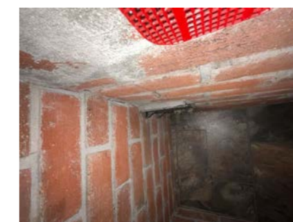
Sotluke har skader på innmuring.
