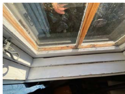
Tegn til innvendig kondensering på glass.
