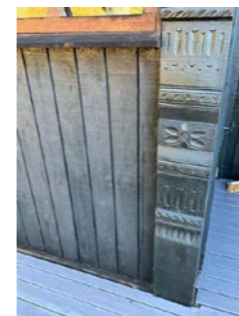
Sprekt kledningsbord på vindfang, fasade mot vest.
