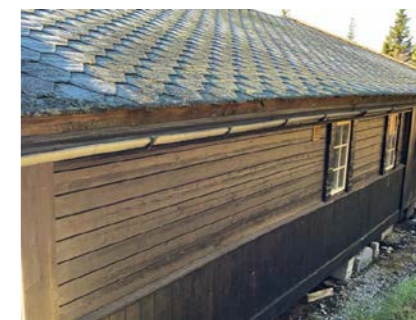
Taktekking preget av slitasje og elde.
