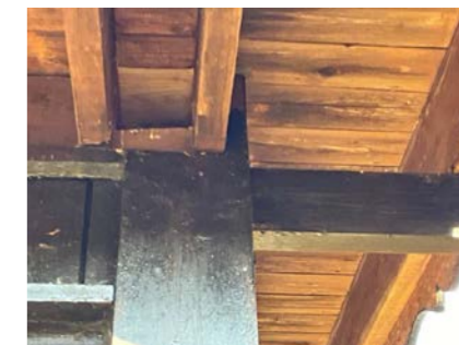
Skadet stussbord i overgang vegg/tak på utvendig hjørne mot sør-øst.
