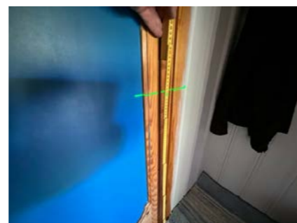
Måling av planavvik. Laserstrøk viser 896mm.
