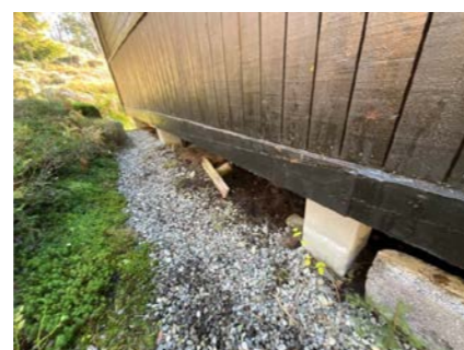
Stor sprekk i svillebord på nord-side.
