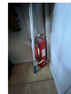
Pulverapparat, sist kontrollert 1997.
