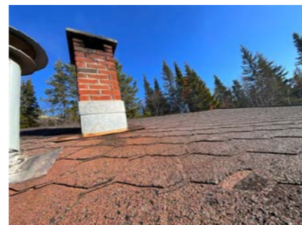
Mangler stigetrinn for feier.
