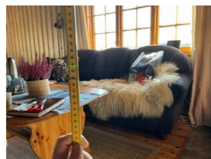
Måling av planavvik. Laserstrøk viser 838mm.
