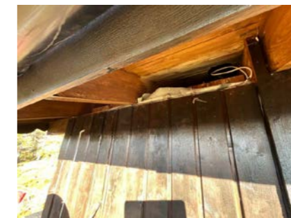
Mangler stussbord i overgang vegg/tak på fasade mot sør. Bildet er av yttervegg på toalettrom.
