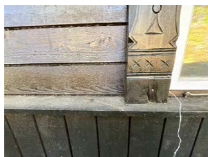
Skade på utvendig belistning, på nord-side
