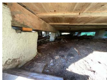
Bilde tatt under bygget viser skjeve fundamenter, bilde tatt på øst-side av bygget.
