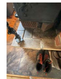
Sprekk i fundament under ovn. Fundamentet er gammel peisgrue.
