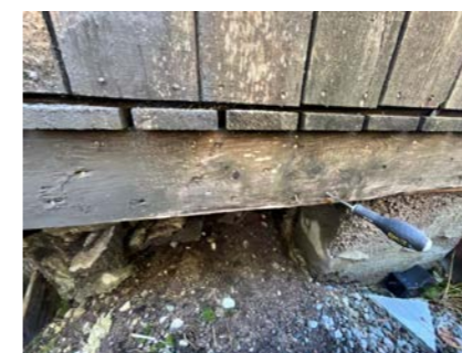
Råteskade i bunnstokk på nord-side, ved vindfang.
