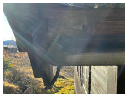
Endelokk på takrenne på nord-øst side er løst.
