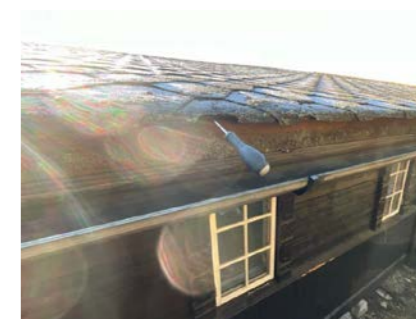
Råteskade flere steder i nederste bord i undertaket på nord-side.
