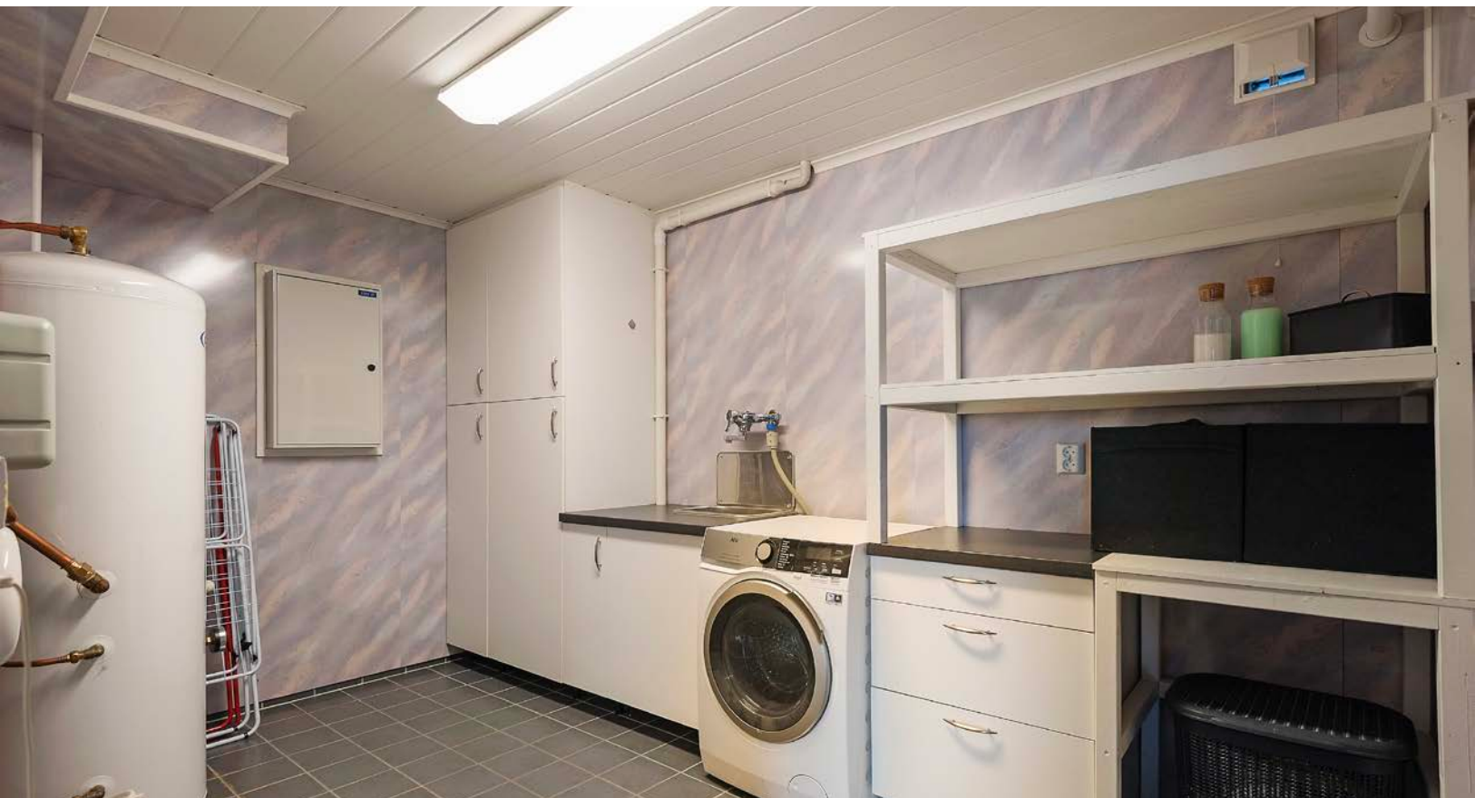
Vaskerom i underetasjen.
