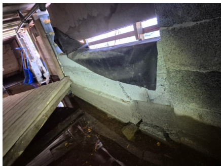
Utsigning og vannansamling i mur mot øst.
