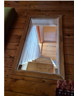
Mangler rekkverk og håndløper.
