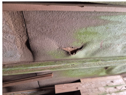
Skader på flere av platene.
