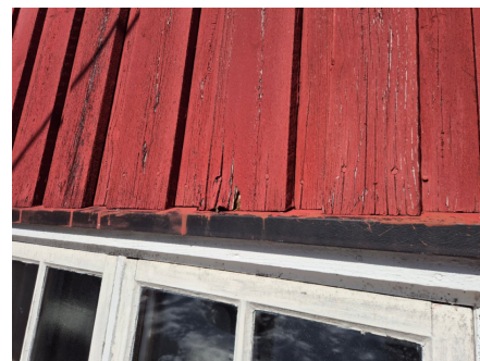
Råte i kledning over vindu.
