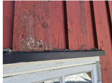
Værslitt og råte i kledning over vindu.
