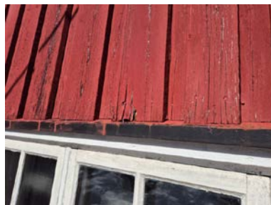
Råte i kledning over vindu.
