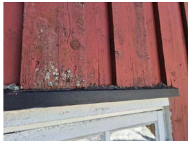
Værslitt og råte i kledning over vindu.
