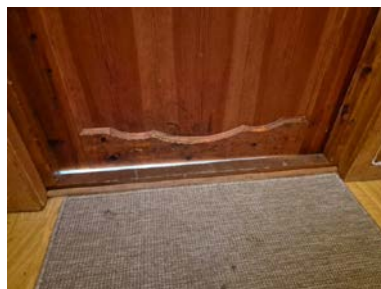
Utett mellom dør og terskel.
