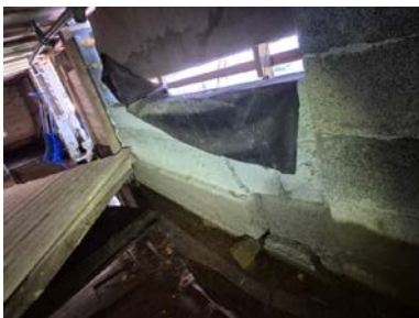
Utsigning og vannansamling i mur mot øst.
