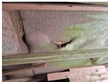
Skader på flere av platene.
