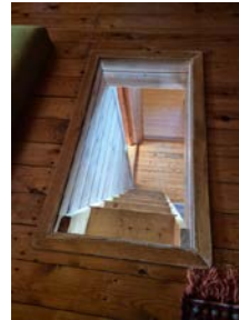
Mangler rekkverk og håndløper.
