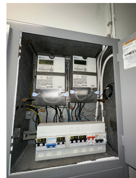
Sikringsskap med automatsikringer.
