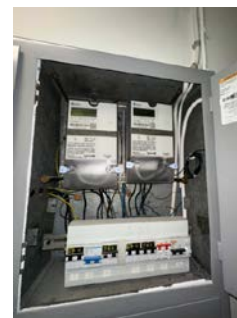
Sikringsskap med automatsikringer.
