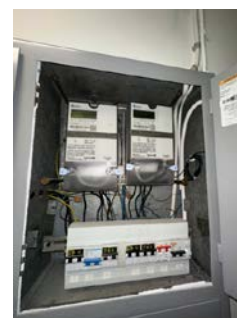
Sikringsskap med automatsikringer.
