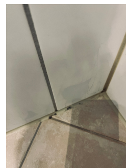
Antydning til noe svertesopp i fuger i dusj
