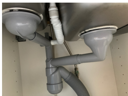
Rørplegget i kjøkkenet
