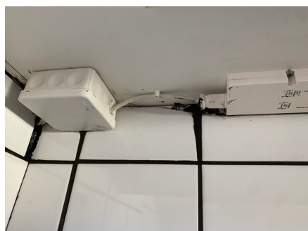
Lampettledning tilkoblet koblisboks
