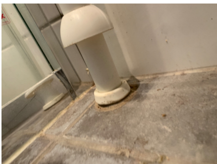
Ingen synlig rørmansjett over gulv
