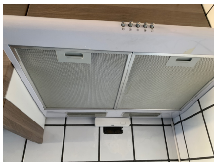
Kulfilterventilator. Synlig komfyrvakt
