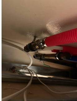
Stoppekran plassert i luke i bad
