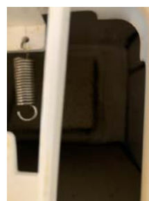
Fra ventil i oppføring som gir tilgang til forsert avtrekk
