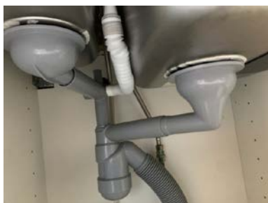
Rørplegget i kjøkkenet
