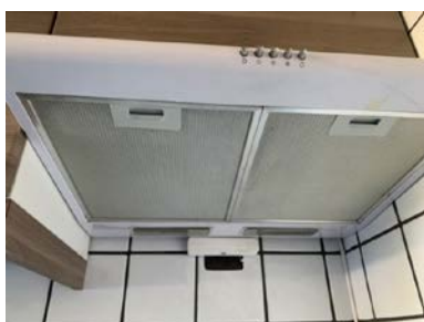
Kullfilterventilator. Synlig komfyrvakt
