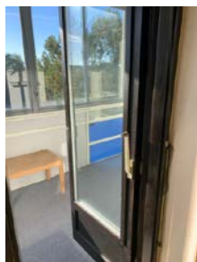
Balkongdør med malt treramme
