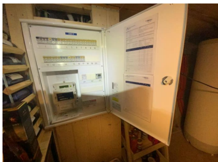
El-skap med automatsikringer og med kursfortegnelse.
