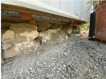
Avskalling av mur mot sørvestlig.
