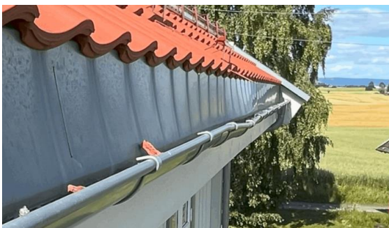
Takrenne mot øst har deformasjon.
