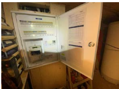
El-skap med automatsikringer og med kursfortegnelse.
