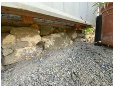
Avskalling av mur mot sørvestlig.
