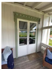
Balkongdør er vanskelig og lukke.
