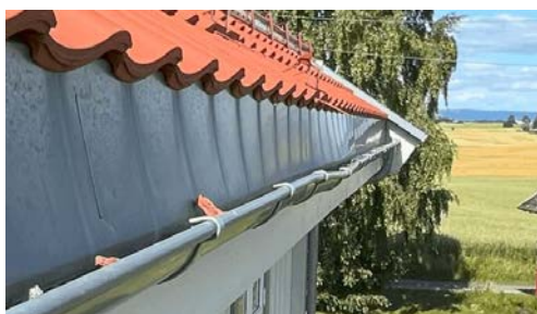
Takrenne mot øst har deformasjon.
