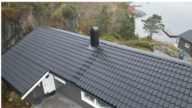
Manglende snøfangere på taket.
