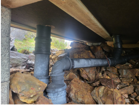
Utvendige avløpsrør under hytta.
